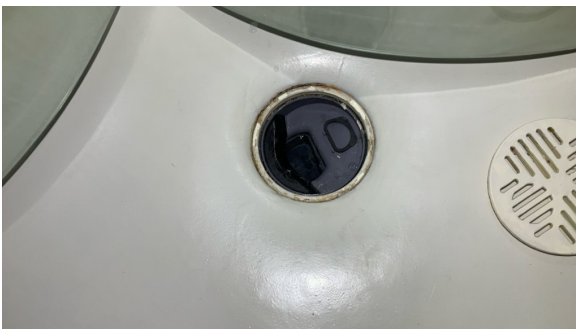
Sluk i dusjsonen.
