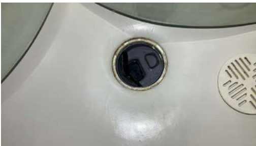
Sluk i dusjsonen.
