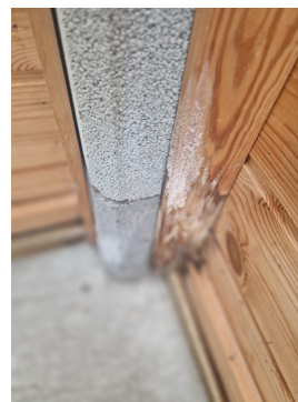
Råteskader i trevirke overbygget terrasse.
