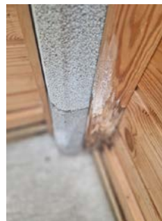
Råteskader i trevirke overbygget terrasse.
