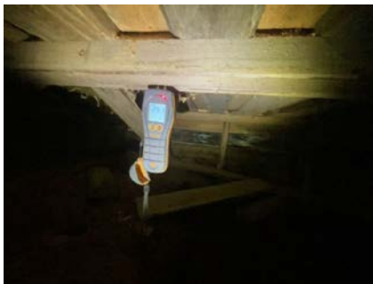
Gammel krypkjeller fukt i stubbloft
