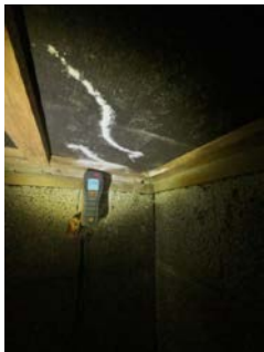
Nyere krypkjeller fukt og "hvitt belegg"
