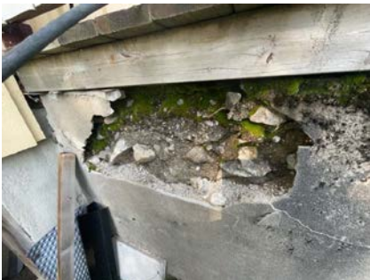
Forvitring tidl. betongterrasse
