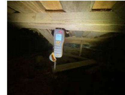
Gammel krypkjeller fukt i stubbloft
