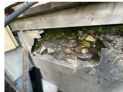
Forvitring tidl. betongterrasse
