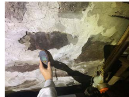
Godt synlig fukt på mur mot terreng "grovkjeller"
