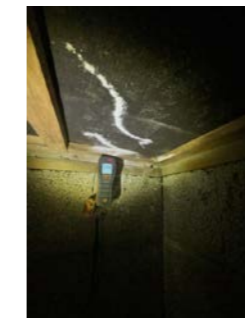
Nyere krypkjeller fukt og "hvitt belegg"
