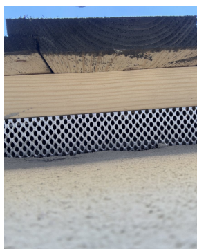
God lufting og musetetting bak kledning
