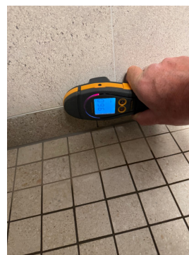
Forhøyede fuktindikasjoner rundt plateskjøter
