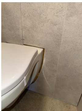
Ufagmessig utførelse og detaljeløsning.
