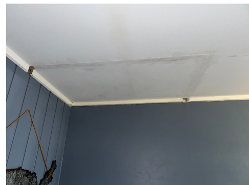
Merker etter tidligere gard.skap i tak på soverom
