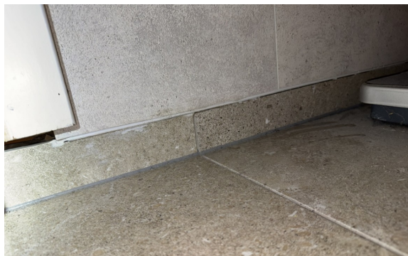
Ingen synlig bunnskinne på våtromsplater
