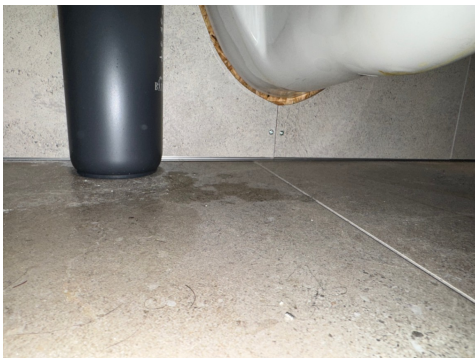
Ingen drenering eller andre løsninger for å synliggjøre lekkasje.
