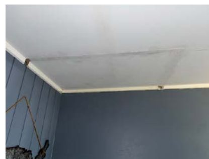
Merker etter tidligere gard.skap i tak på soverom
