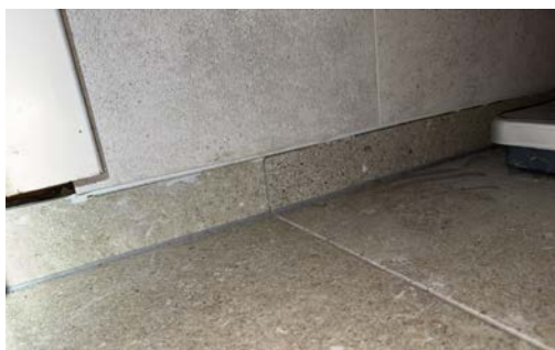
Ingen synlig bunnskinne på våtromsplater
