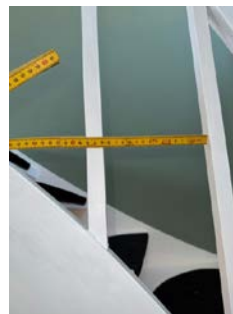
Avstand mellom spiler i rekkverk 16cm.
