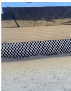
God lufting og musetetting bak kledning
