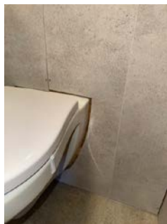
Ufagmessig utførelse og detaljeløsning.
