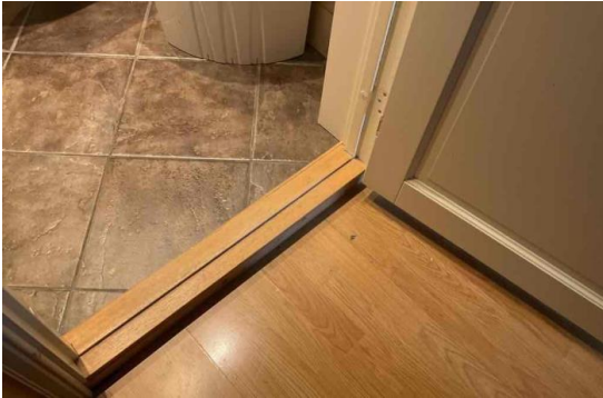
Terskel ved dør i bad.
