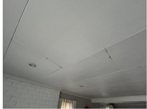
Skade i overflate
