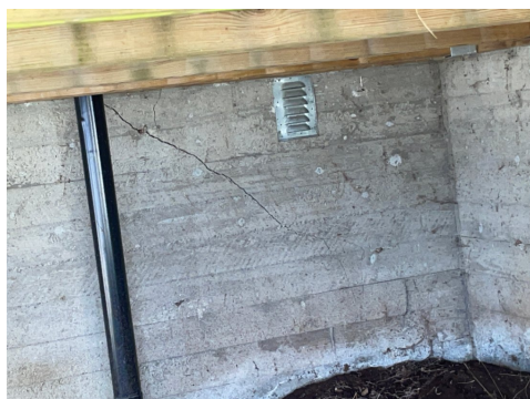
Sprekk i mur etter setninger
