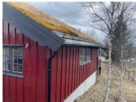
Synlige skjevheter i takkonstruksjon mot vest
