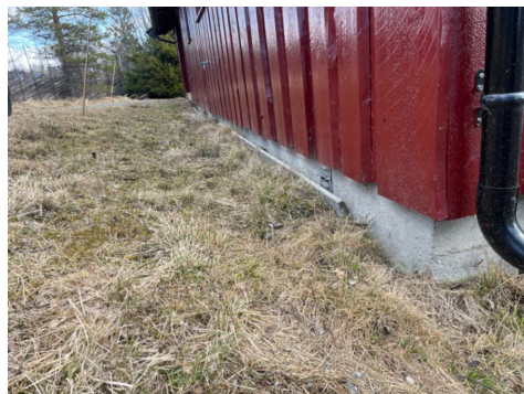
Terreng faller inn mot yttermur.
