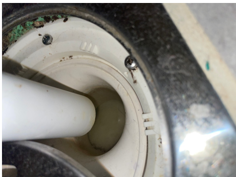
Sluk under dusjkabinett
