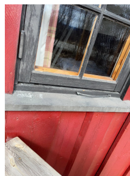
Vinduer har manglende vedlikehold
