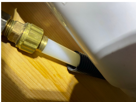
Manglende tettemuffer på varerør på kjøkken.
