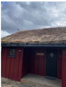
Kledning går stedvis ned til terreng.
