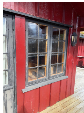
Vinduer har manglende vedlikehold
