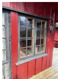
Vinduer har manglende vedlikehold
