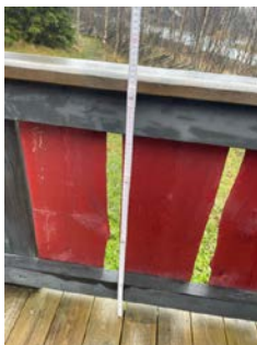
Rekkverkshøyde under krav for bygge
