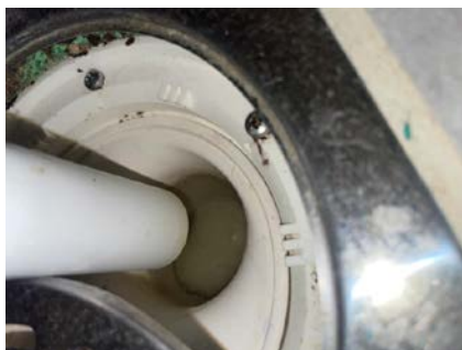
Sluk under dusjkabinett
