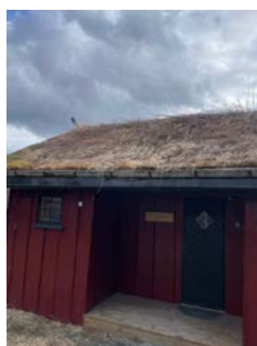
Kledning går stedvis ned til terreng.
