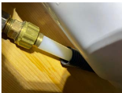
Manglende tettemuffer på varerør på kjøkken.
