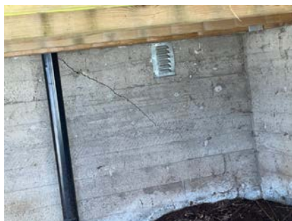
Sprekk i mur etter setninger
