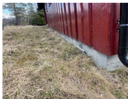
Terreng faller inn mot yttermur.
