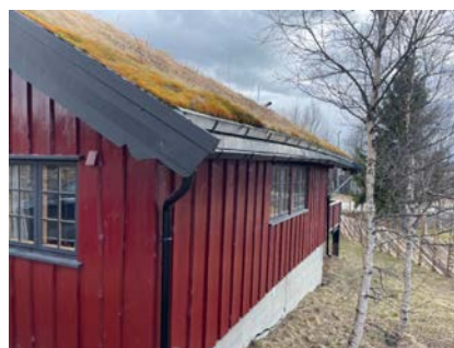
Synlige skjevheter i takkonstruksjon mot vest
