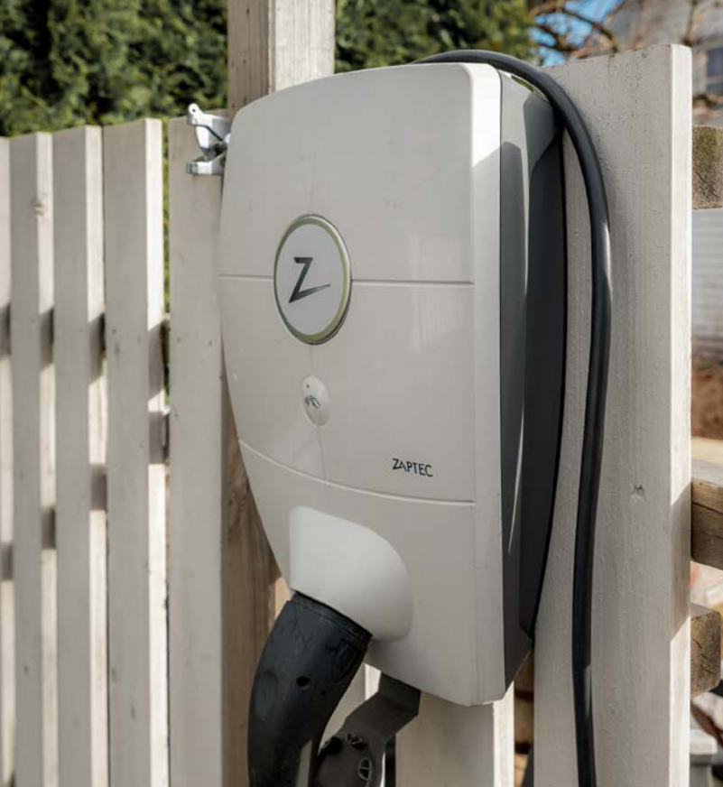
Plassen er utstyrt med lader fra merket ZapTec.
