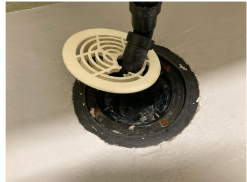
Sluk på vaskerom.
