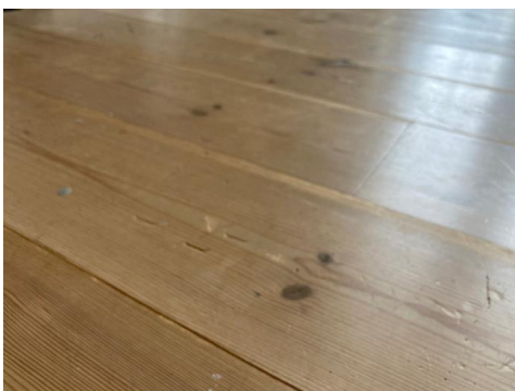
Tregulv har slitasje og merker.
