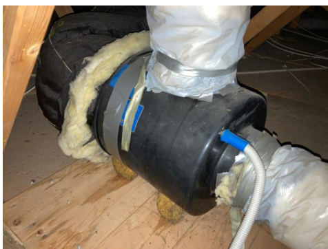
Avtrekksmotor på møneloft.
