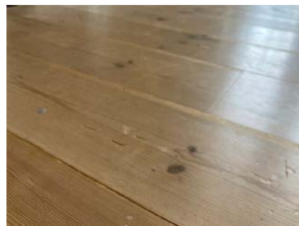
Tregulv har slitasje og merker.
