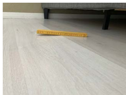
Laminatgulv har reiste skjøter.
