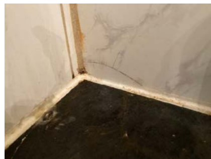
Sprekk i veggflis og ikke fleksibel fugemasse i dusjsone.
