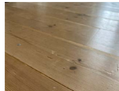
Tregulv har slitasje og merker.
