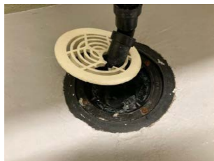
Sluk på vaskerom.
