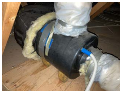
Avtrekksmotor på møneloft.
