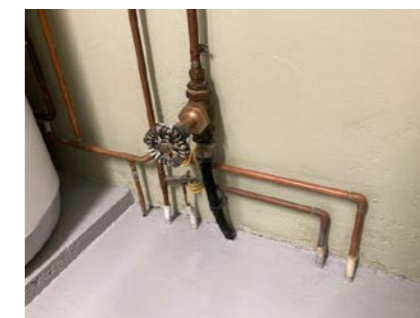
Stoppekran på vaskerom.
