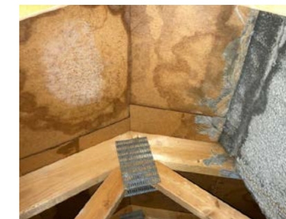
Fuktmerker ved gjennomføring av pipe.
