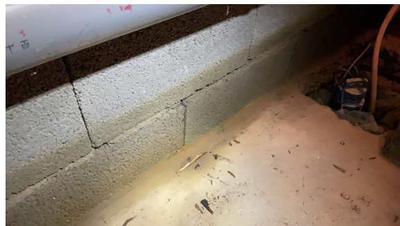
Vannlinje på vegg etter hvor høyt vann har stått.
