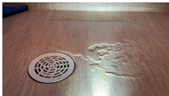
Manglende lokalt fall i dusjsone og vannspeil blir stående og renner ikke til sluk.
