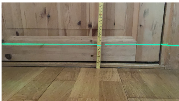
Målt skjevhet: 41mm
