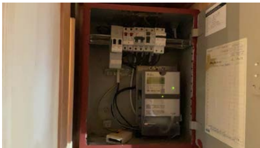
Sikringsskap plassert på kjøkken.
