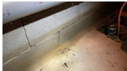
Vannlinje på vegg etter hvor høyt vann har stått.
