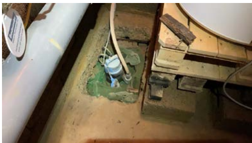
Lensepumpe plassert i kjeller for å pumpe ut vann.
