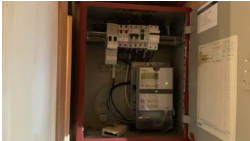
Sikringsskap plassert på kjøkken.
