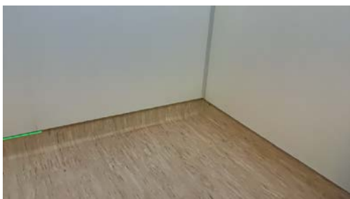
Våtromsplater mangler fuge/dekkelist i bunn av plate.
