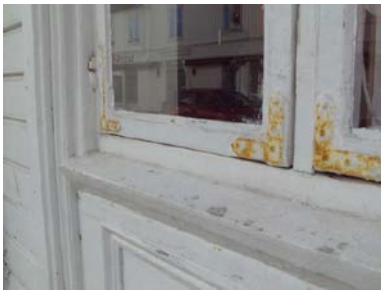
Gamle vinduer i deler av første etasje
