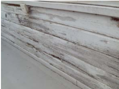
Større råteskader i rekkverk i leilighet nummer 1
