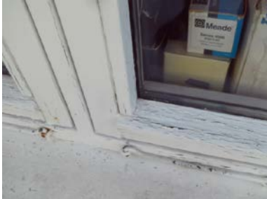
Større slitasje på utvendig karm og ramme.
