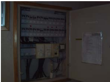
Sikringsskap i kjeller.
