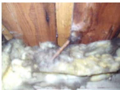
Ingen lufting i mellom undertak og isolasjon.
