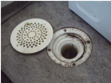
Sluk ved vaskemaskin
