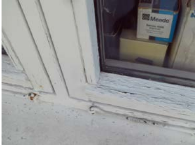
Større slitasje på utvendig karm og ramme.
