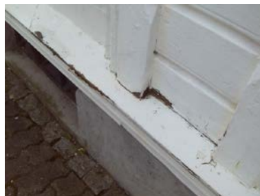
Ingen lufting bak kledningen.
