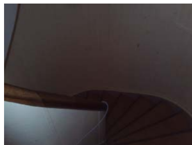
Mangler håndløper på deler av trappen.
