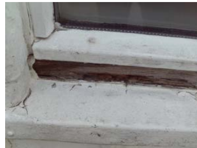
Råteskader i stort vindu i første etasje.
