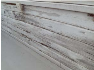
Større råteskader i rekkverk i leilighet nummer 1
