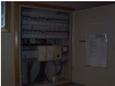
Sikringsskap i kjeller.
