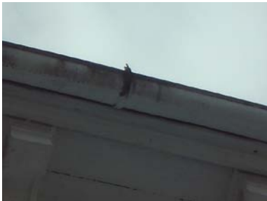
Eldre renner av stål med noe rust på rennekroker.
