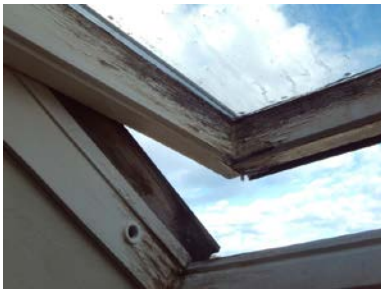
Større skader på takvindu på bad i leilighet 5.
