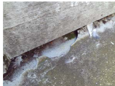
Tekking har sprukket opp.
