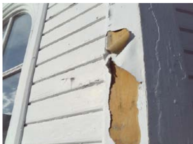
Maling har løsnet i fra underlaget flere plasser
