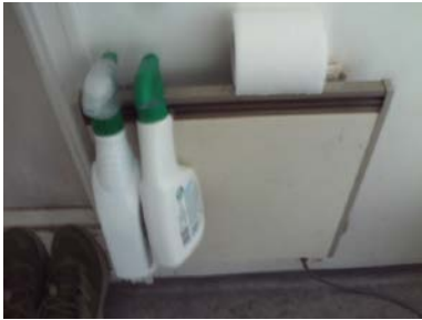
Panelovn som varmekilde.
