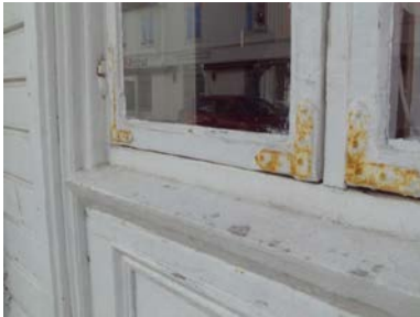
Gamle vinduer i deler av første etasje
