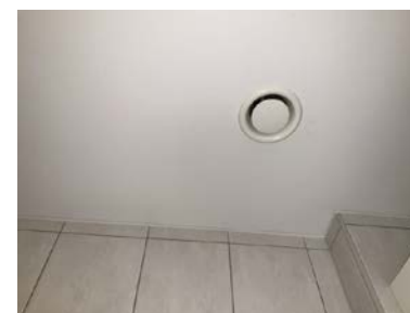
Avtrekksventil i tak
