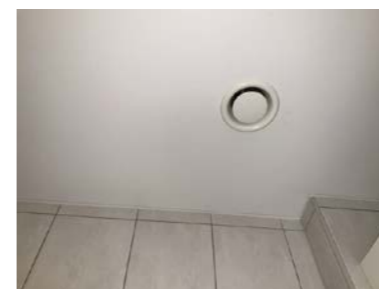
Avtrekksventil i tak
