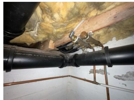
Fordelingskolbe på vann er tilgjengelig i himling over varmtvanntank
