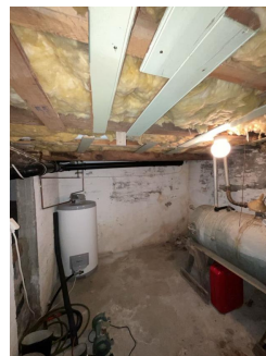
Teknisk rom med åpen isolasjon i himling
