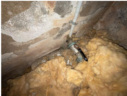
Hovedstoppekrane er plassert på teknisk rom
