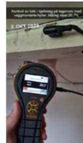
Kontroll av fukt i bjelkelag med veggmontert hyller. Det er målt 20,7%
