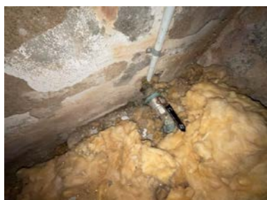
Hovedstoppekrane er plassert på teknisk rom
