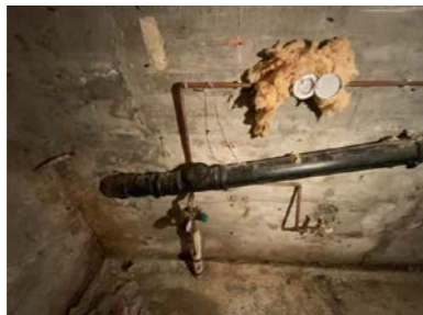
Reduksjonsventil, vannmåler og krane mot uthus er plassert i lagerrom 1
