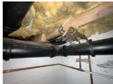
Fordelingskolbe på vann er tilgjengelig i himling over varmtvannstank
