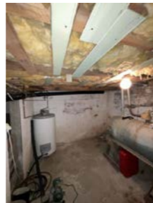
Teknisk rom med åpen isolasjon i himling
