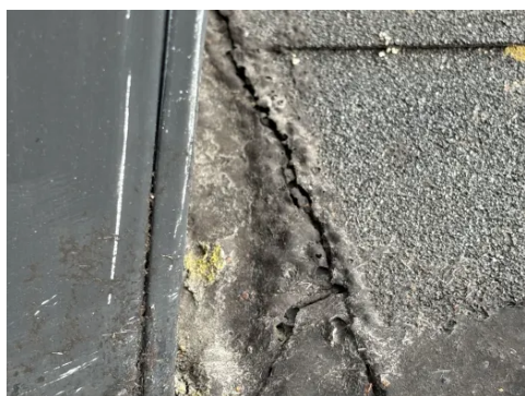
Sprekkdannelse på tekkingen ved rundt takgjennomføringer.
