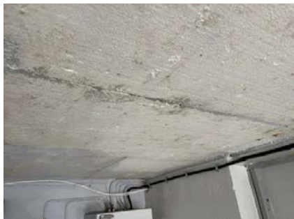
Synlig isopor i garasjens himling.
