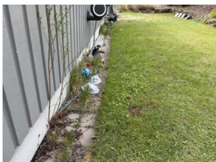
Terrenget heller inn mot grunnmurskonstruksjonen.
