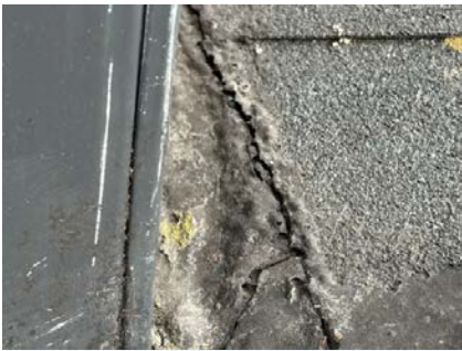
Sprekkdannelser på tekkingen ved rundt takgjennomføringer.
