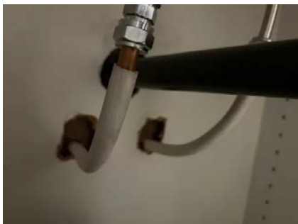
Det er ikke synlig tettesjikt rundt rørføringer i vegg til servant.
