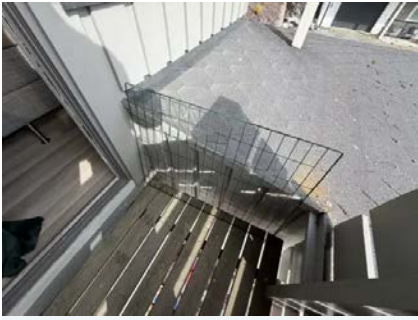
Kun et enkelt provisorisk rekkverk.
