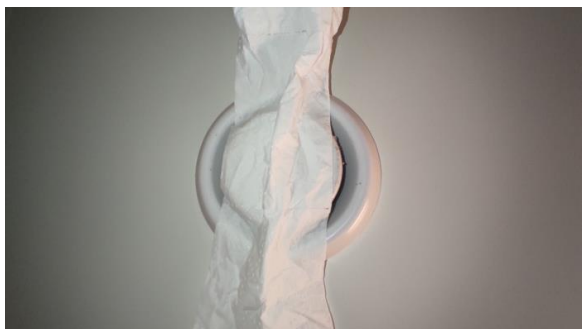
Test av avtrekket.
