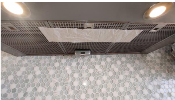
Test av avtrekket.
