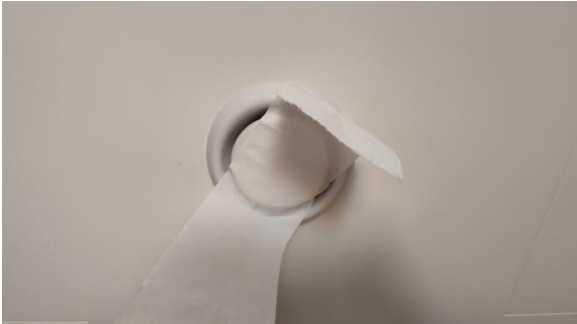
Test av avtrekket.
