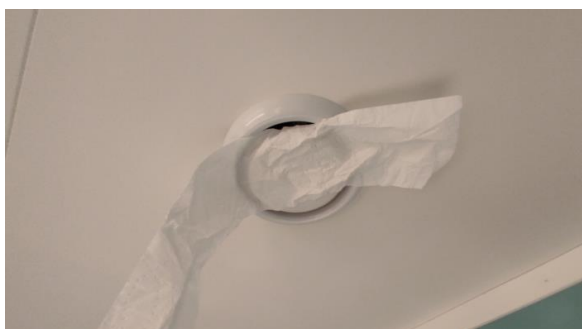
Test av avtrekket.
