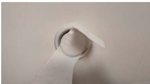
Test av avtrekket.
