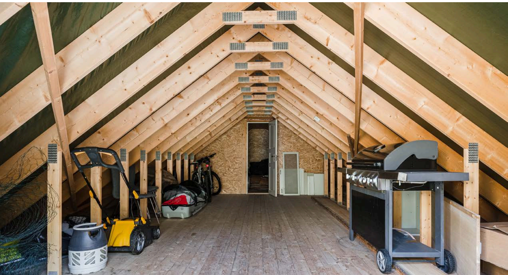
Loftsplanet har et stort, uinnredet rom med potensiale samt et bodrom innerst.
