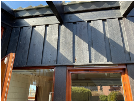
Råteskader treverk ved inngangspartiet.
