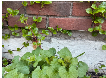
Noe sprekker i betongen.
