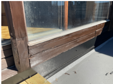
Råteskader i treverket.
