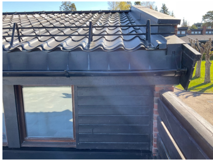
Deformasjon i takrenne.
