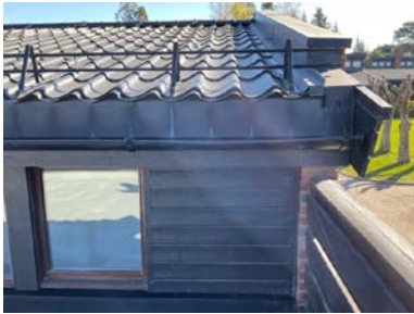
Deformasjon i takrenne.
