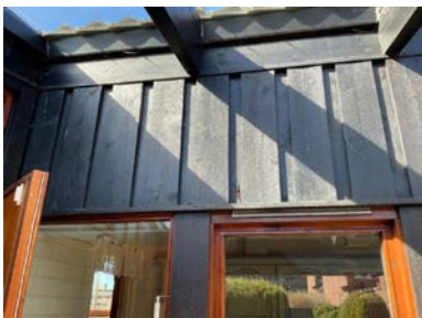
Råteskader treverk ved inngangspartiet.
