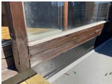
Råteskader i treverket.
