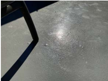
Enkelte bobler i gulvmaling.
