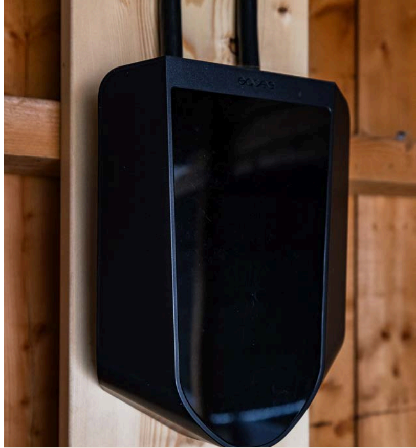
Det er montert elbil-lader.
