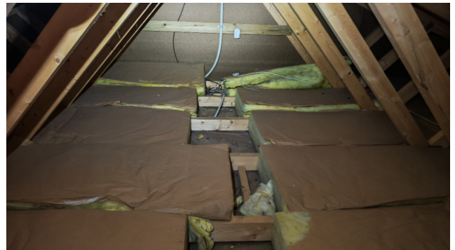
Stedvis noe manglende isolasjon
