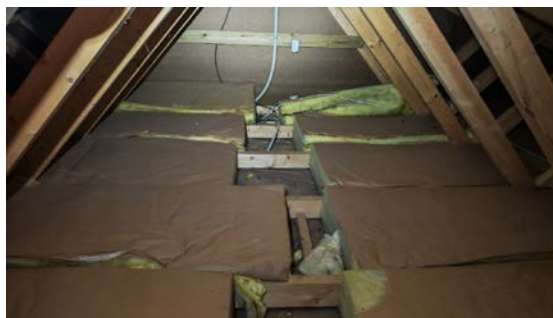
Stedvis noe manglende isolasjon
