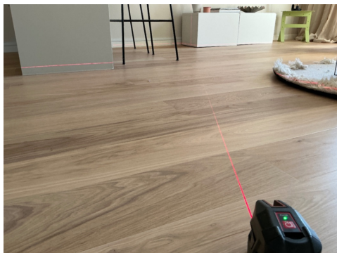
Nivellering stue/kjøkken, avvik ca. 15-30 mm
