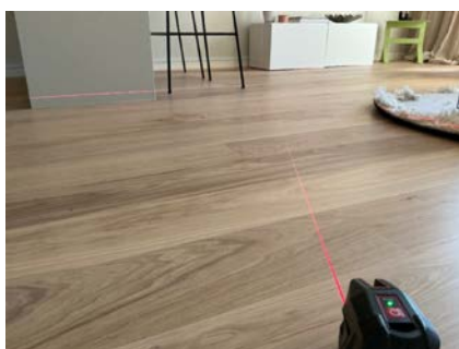
Nivellering stue/kjøkken, avvik ca. 15-30 mm
