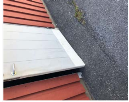
Dør som subber mot terreng
