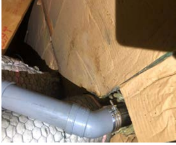
Fuktskjolder på isolasjon. Antatt fra kondens
