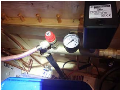
Oppkobling inntak fra grunnvannsbrønn med stoppekrane og varmekabel ut til brønn.
