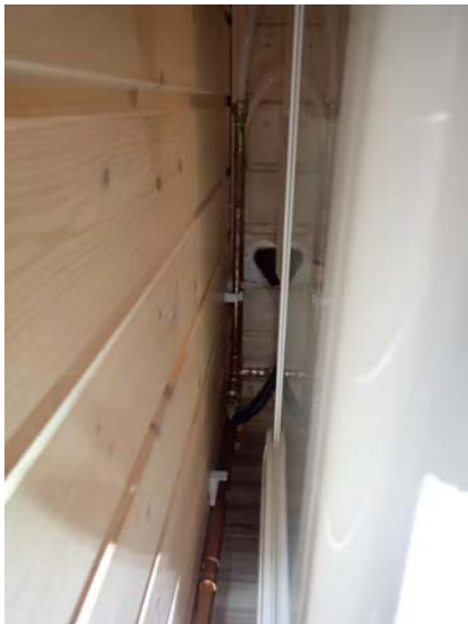
Rør i rør som kommer inn på dusjrom bak dusjkabinett for synliggjøring av eventuelle lekkasjer.
