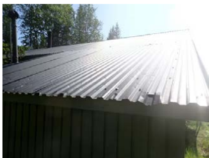
Bulker om mindre skader i takteking.
