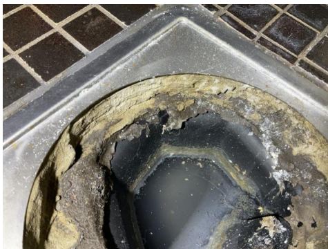
Sluk i dusjsonen.
