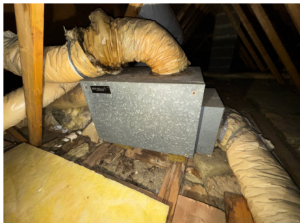
Ventilasjonsaggregat på loft.
