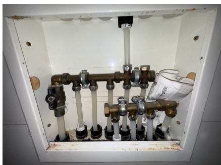
Vannfordelerskap bad/wc hybel
