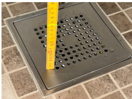
Fallforhold ca. 135 mm topp slukrist i dusjsone
