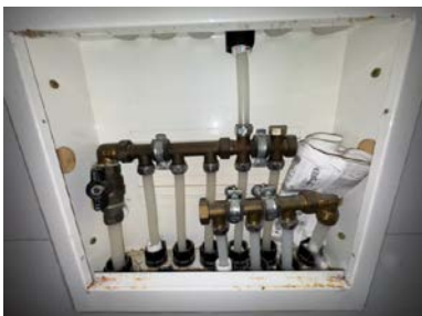
Vannfordelerskap bad/wc hybel
