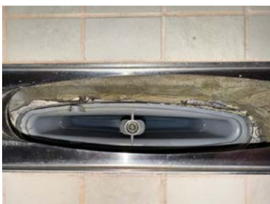
Slukrenne med vannlås ved vegg i dusjsone. Synlig membran/mansjett under klemring.
