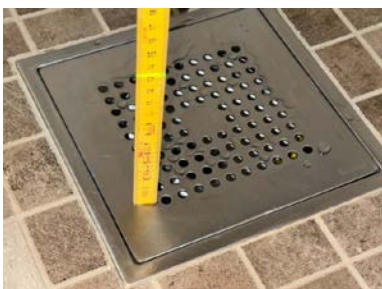
Fallforhold ca. 135 mm topp slukrist i dusjsone
