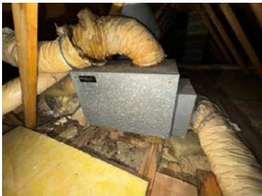
Ventilasjonsaggregat på loft.
