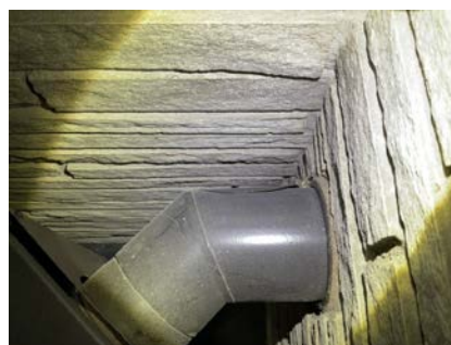
Rørlokk må stenges
