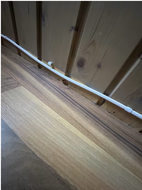
Manglende innfesting av kabler
