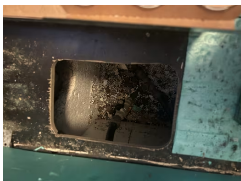
Stoppekran plassert i luke i kjøkkengulvet.
