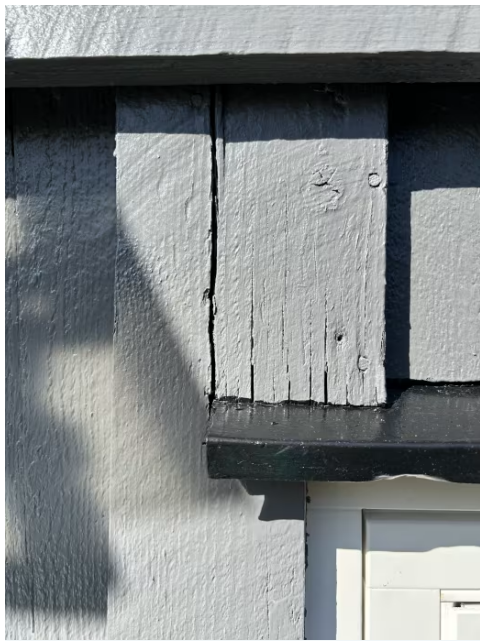
Sprekk i panel.
