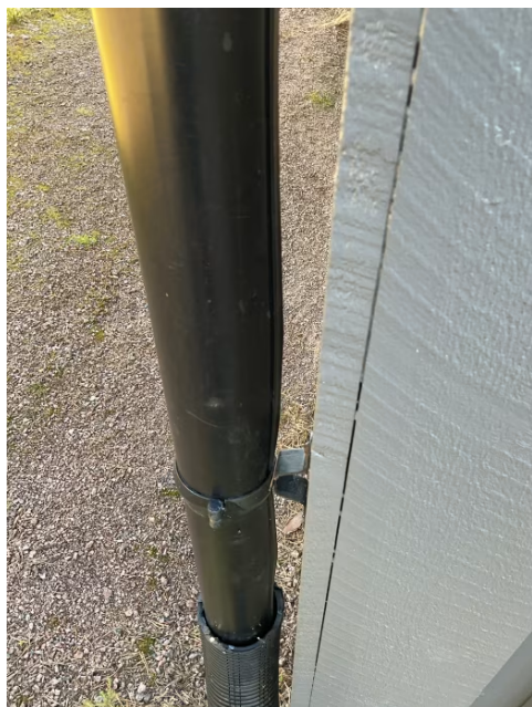
Frostspreng i nedløpsrør.
