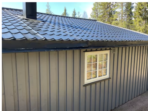
Løst beslag mellom tak og takrenne.
