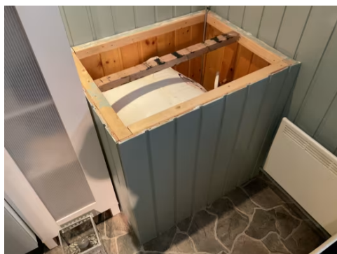
Varmtvannsbereder plassert i tett kasse på bad.
