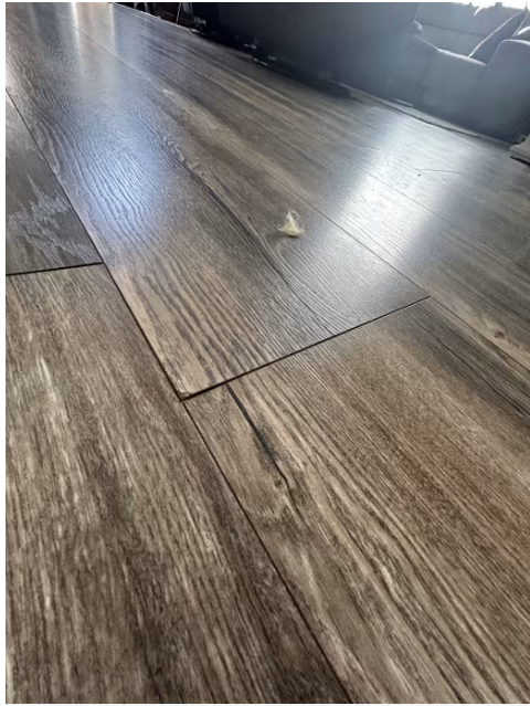
Slipp i laminat gulv.
