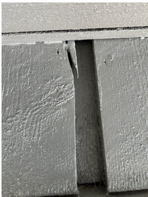
Sprekk i panel.
