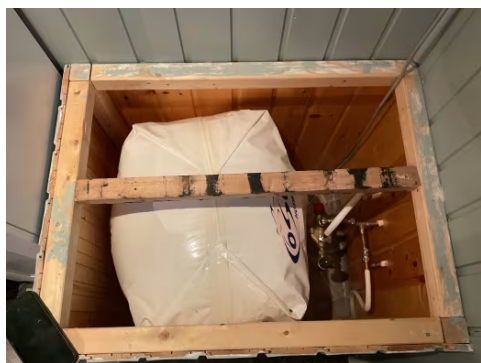
Varmtvannsbereder plassert i tett kasse på bad.
