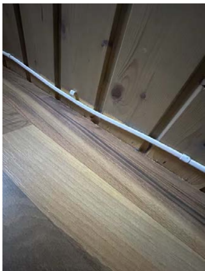
Manglende innfesting av kabler
