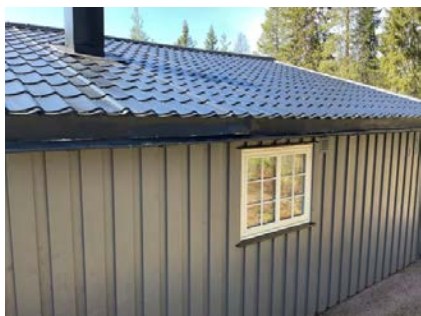
Løst beslag mellom tak og takrenne.
