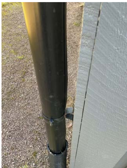
Frostspreg i nedløpsrør.
