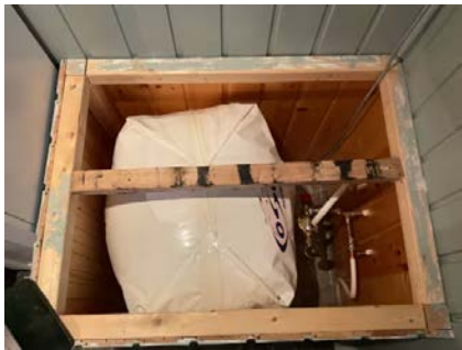
Varmtvannsbereder plassert i tett kasse på bad.
