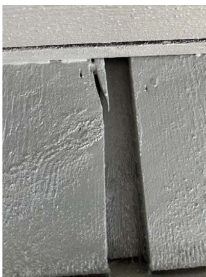
Sprekk i panel.
