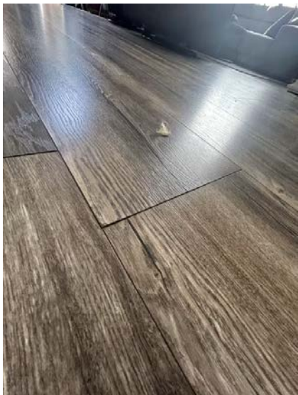
Slipp i laminat gulv.
