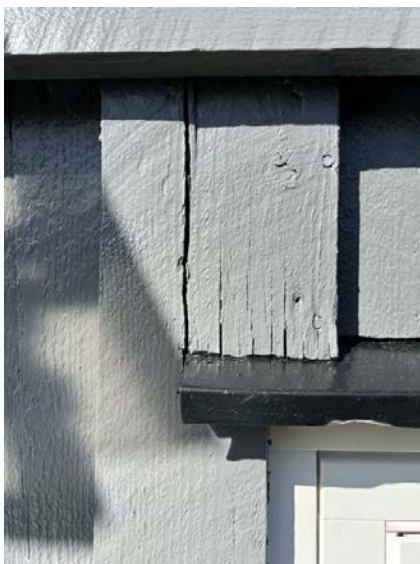
Sprekk i panel.
