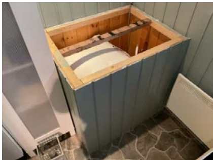
Varmtvannsbereder plassert i tett kasse på bad.
