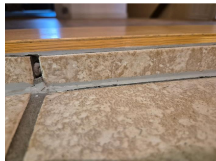
Sprekk i fuger ved terskel.
