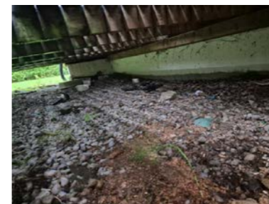
Svakt hellende terreng mot grunnmur.
