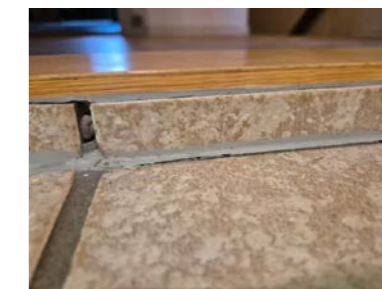
Sprekk i fuger ved terskel.
