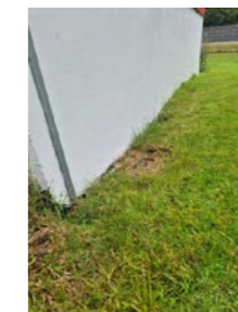
Svakt hellende terreng mot grunnmur.
