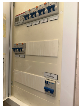
Sikringsskap med automatsikringer.
