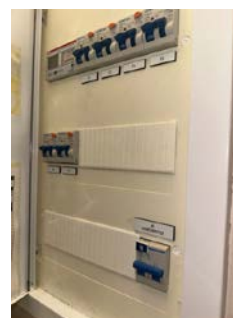
Sikringsskap med automatsikringer.
