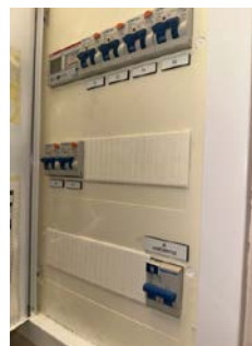
Sikringsskap med automatsikringer.
